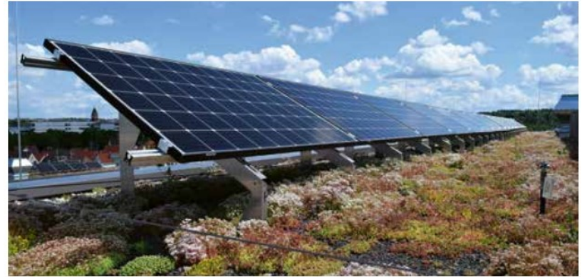
Abb. 20: Auch eine Kombination aus Solarmodulen und Dachbegrünung ist möglich.
