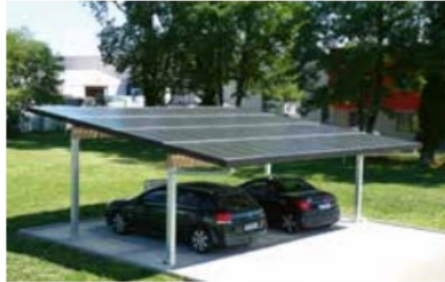
Abb. 19: Solar-Carports sind in unterschiedlichen Ausführungen erhältlich.
